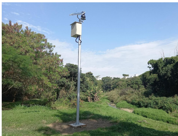
Figura 8 Estação pluviométrica instalada no córrego Senhorinha Fonte: FCTH,2023
